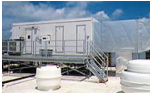
Εικόνα 1.17. Κεντρική μονάδα κλιματισμού αίθουσας χειρουργείου
